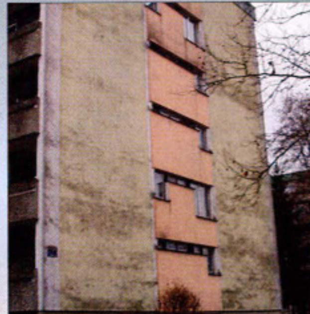
Растительный и грибковый налет на плоскостях фасадов
